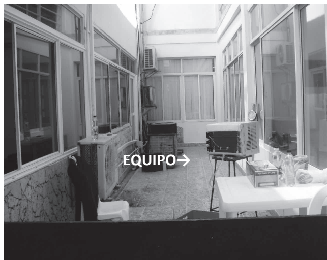
Figura 3. Ubicación del prototipo condensador de agua en San Andrés isla Colombia: rodeado por edificios a techo abierto y corredor que dan al exterior por donde circula el aire Fuente: Los autores.
